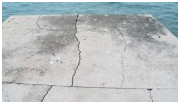
Parterno oštećenje gata
