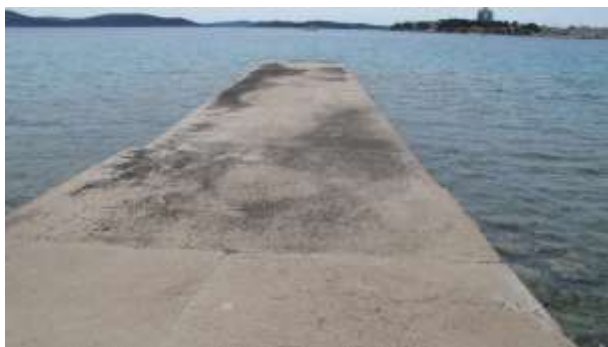
Oštećenje na južnom gatu
